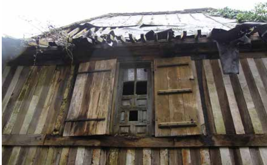
Fig. 9 - Lisieux, manoir des Mathurins : façade nord du pavillon nord, fenêtre conservant son châssis, 2018.
